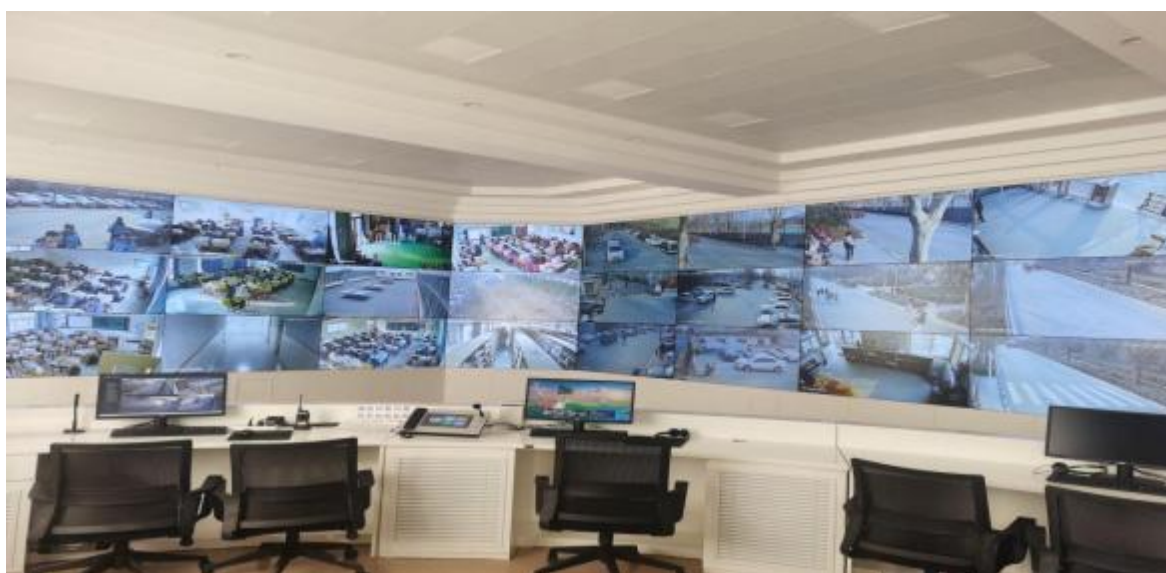
图为：监控中心
